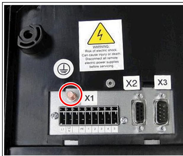
Imagen 11: Punto de conexión, compensación de potencial
